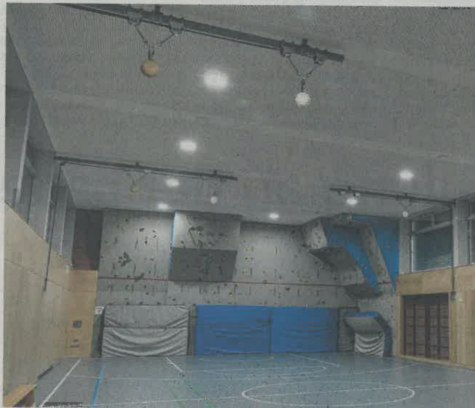
Die Kiefersfeldener Schulturnhalle erstrahlt im Lichte der neuen LED-Leuchten.
